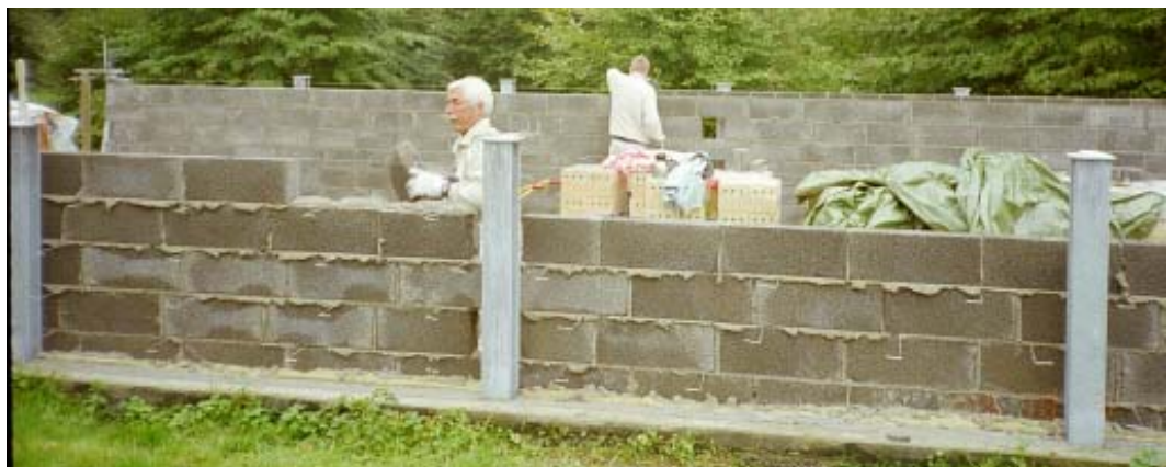
19. oktober: Dagen efter: De to lange bagmure er næsten oppe i fuld højde.
